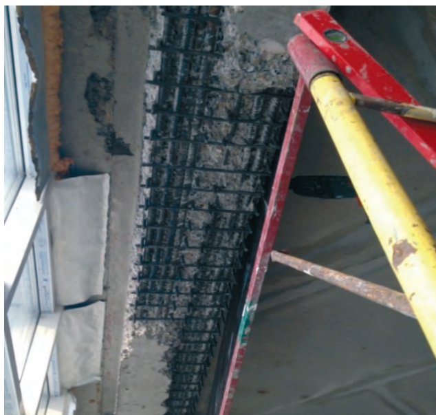
Рисунок А.1.3.1 – Монолитные густоармированные участки железобетонных балок с участками оголенной арматуры
