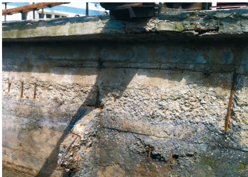
Рисунок А.1.2.1 – Разрушенные участки бетона с оголенной арматурой в сжатой зоне
