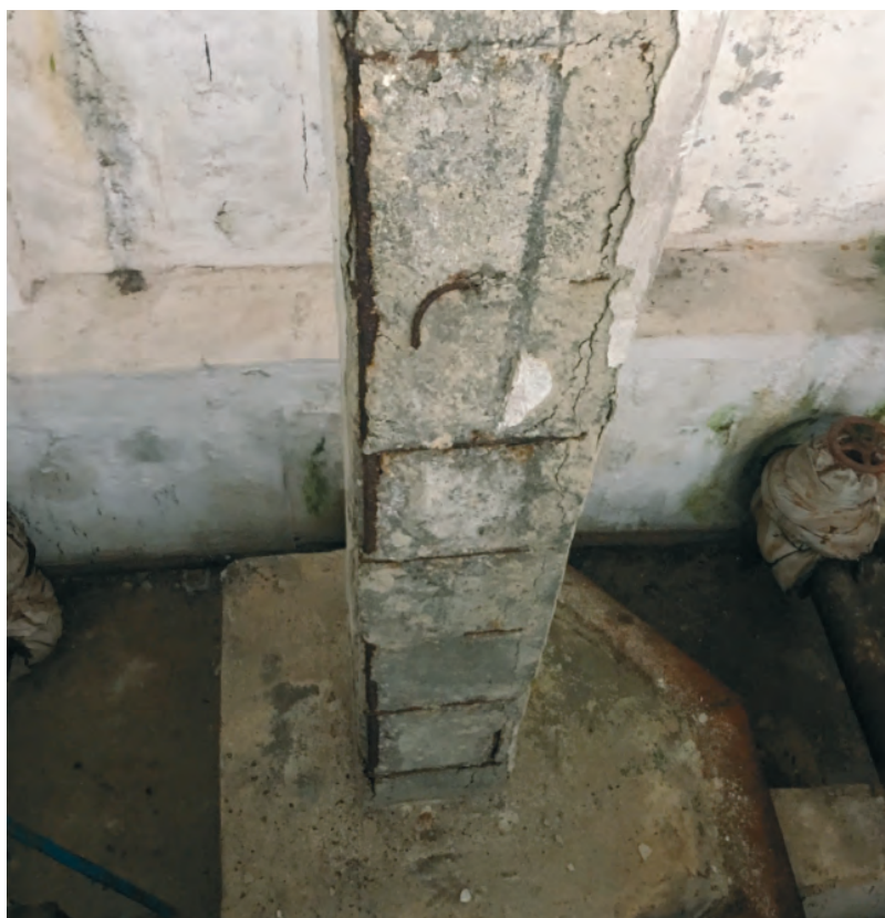
Рисунок А.1.2.4 - Железобетонные колонны с поврежденным защитным слоем железобетона и участками оголенной арматуры
